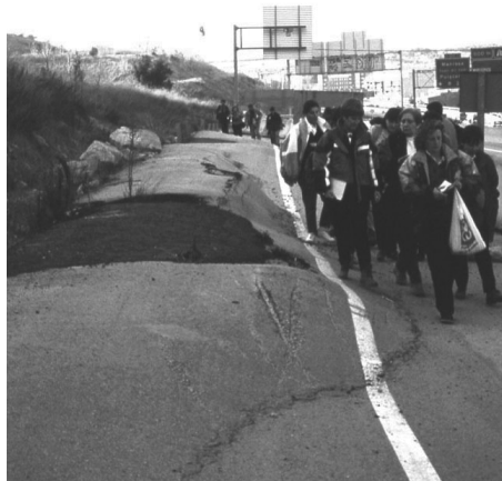
Fig. 2. Carretera C-58. SW de Terrasa. Ejemplo de deformaciones en 1999.
